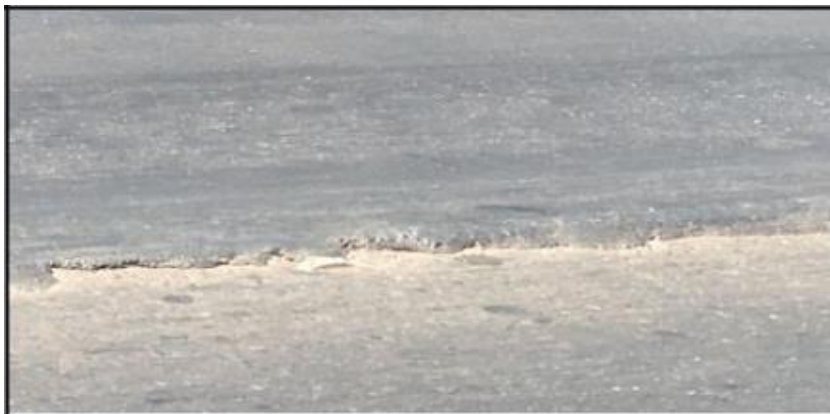
Figura 3: Esxudação no Pavimento
