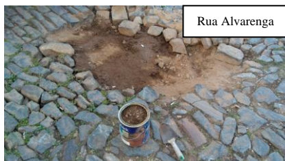
Figura 1: Coleta de material da base do pavimento, decorrente de uma panela
