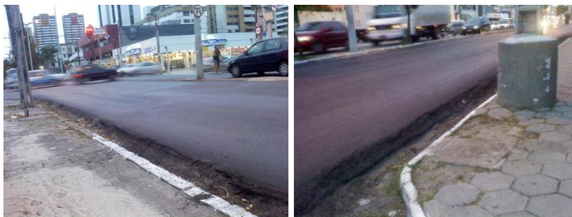
Figura 1: Projeto geométrico comprometido com revestimento em cotas superiores às das calçadas (Fonte: Jornal O Povo, 2010)
