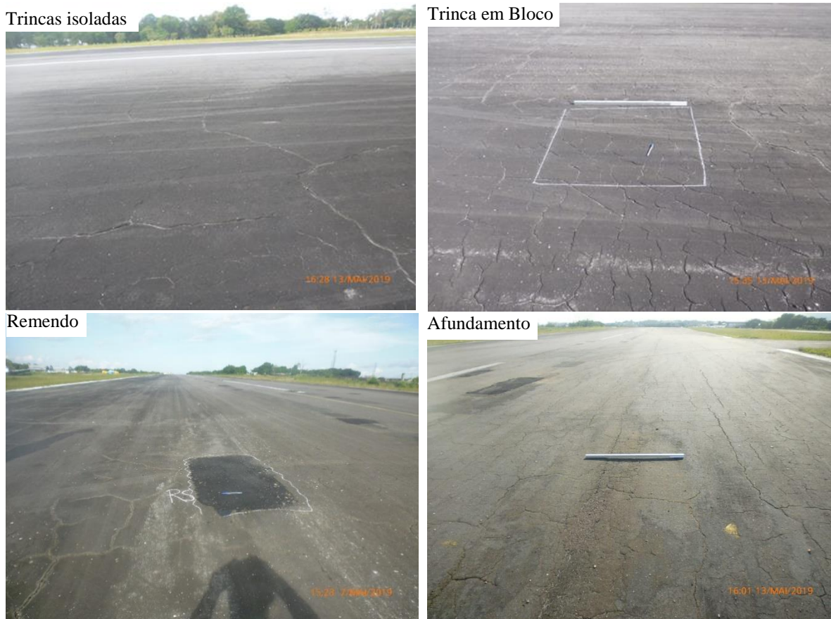
Figura 2: Aspecto geral das patologias encontradas.
